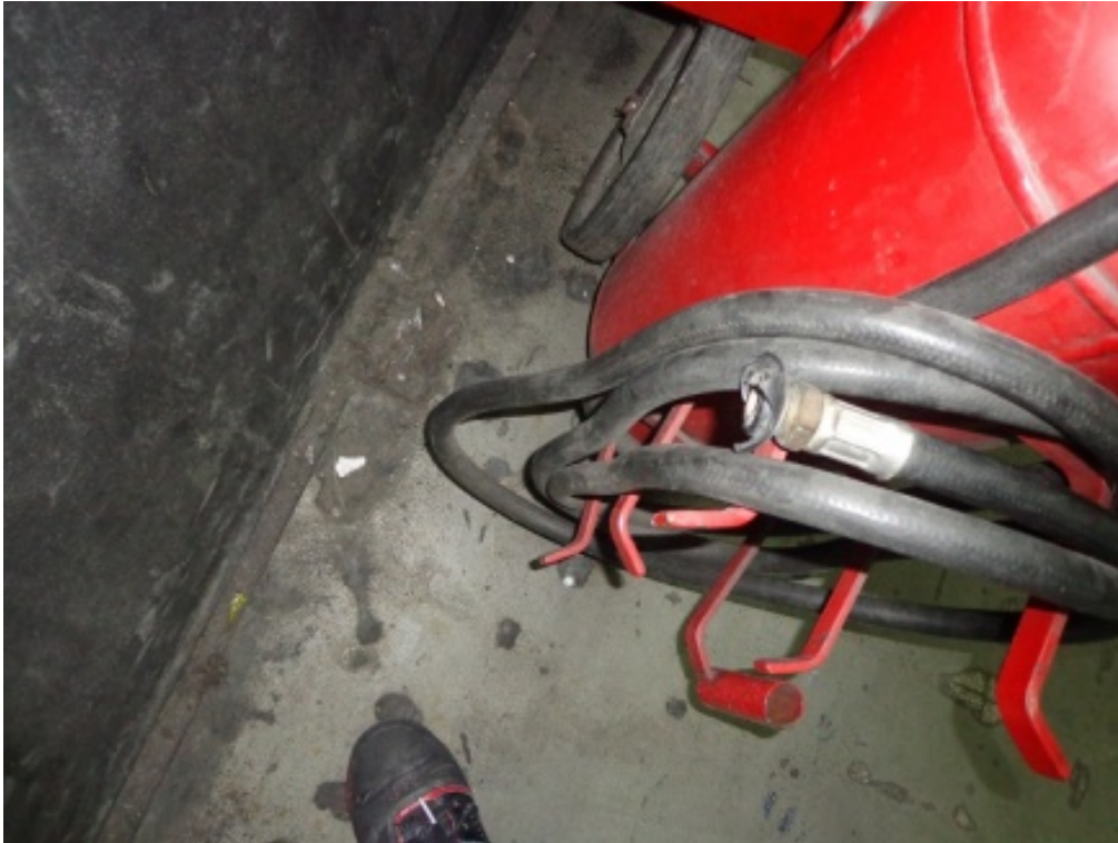
Elementos de incendio en mal estado y con faltantes. Pueyrredón – Línea B
