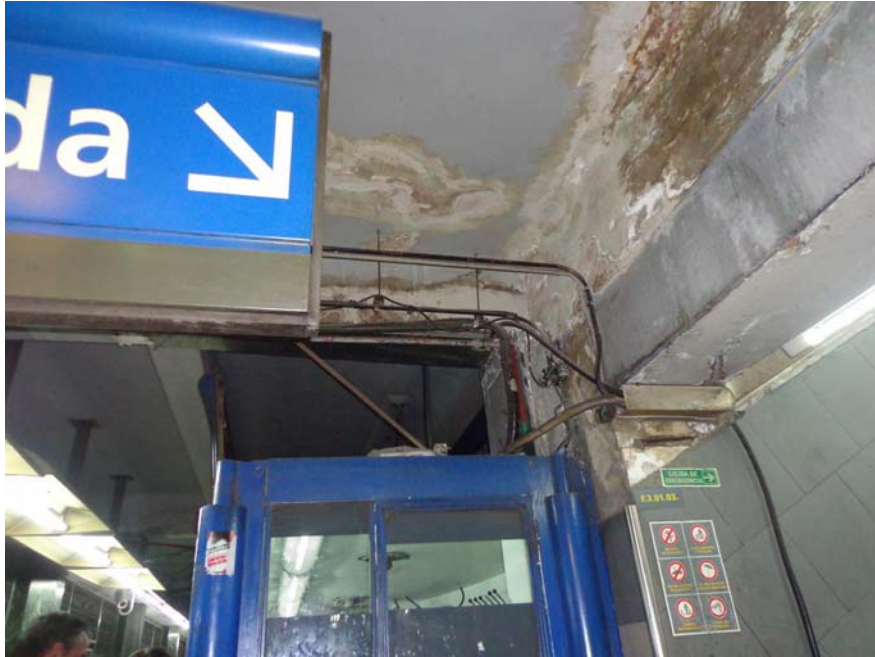
Filtraciones de agua y humedad en paredes y cielorrasos. Constitución – Línea C
