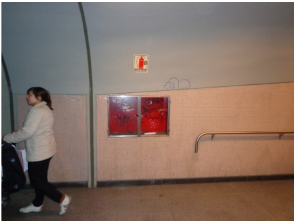
Nicho de Incendio vacío. Pueyrredón – Línea B
