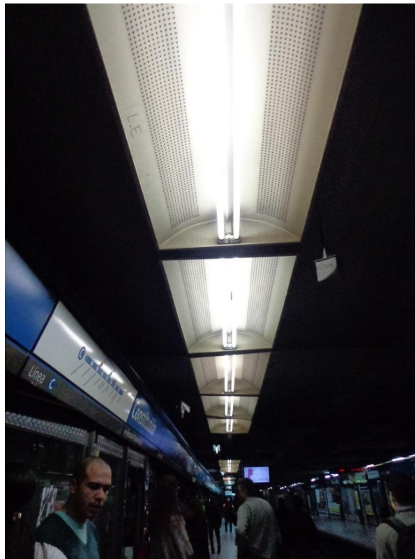
Iluminación general de andenes sin protección en los tubos para evitar su desprendimiento. Constitución – Línea C
