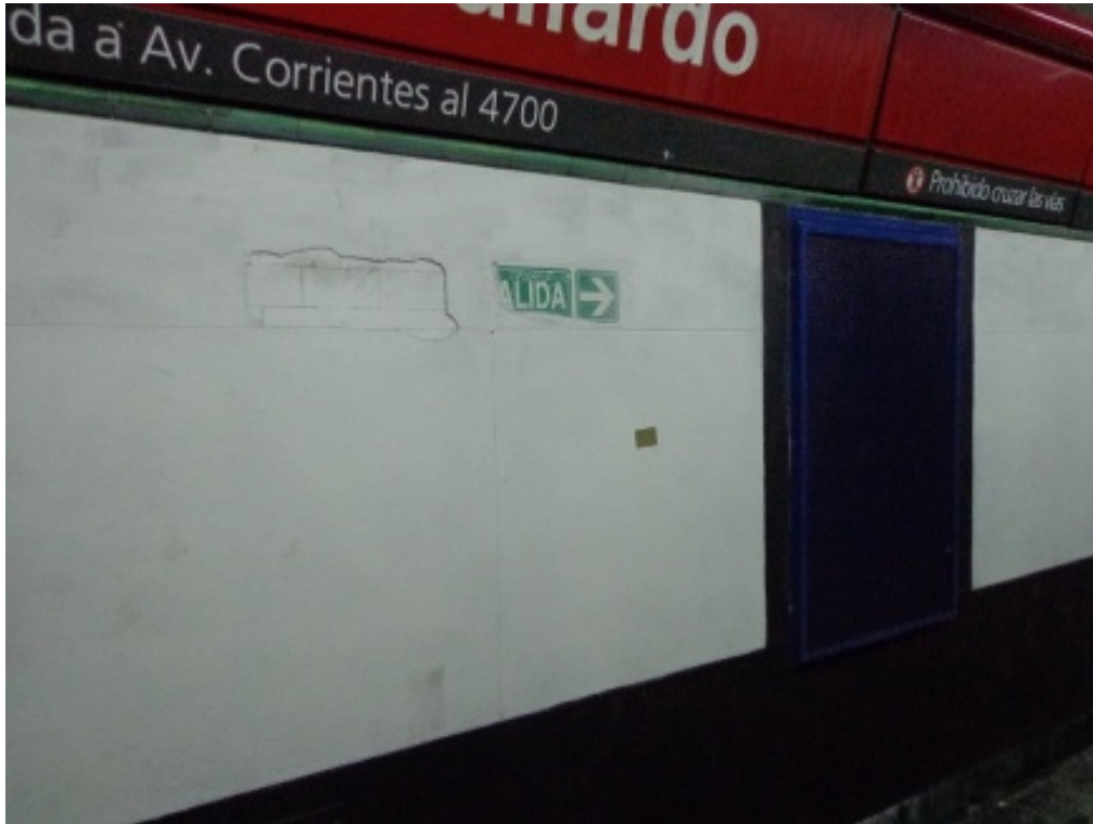
Falta de mantenimiento en señalización de salida A. Gallardo – Línea B
