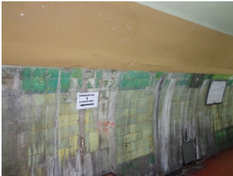
Filtraciones de agua y humedad en paredes y cielorrasos. Jujuy – Línea E
