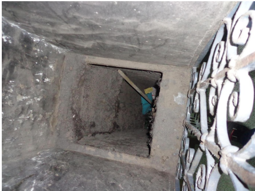
Ventilación natural de la estación obstruida con basura y en desuso. 9 de Julio – Línea D
