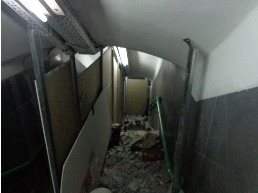
Única escalera fija en obra y en funcionamiento con un paso para usuario de 0.60 cm F. de Medicina – Línea D
