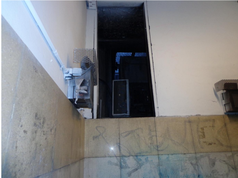
Ocupación de un ventilación natural con equipos condensadores de AA. Hall distribuidor 9 de Julio interconexión con Líneas B y C.
