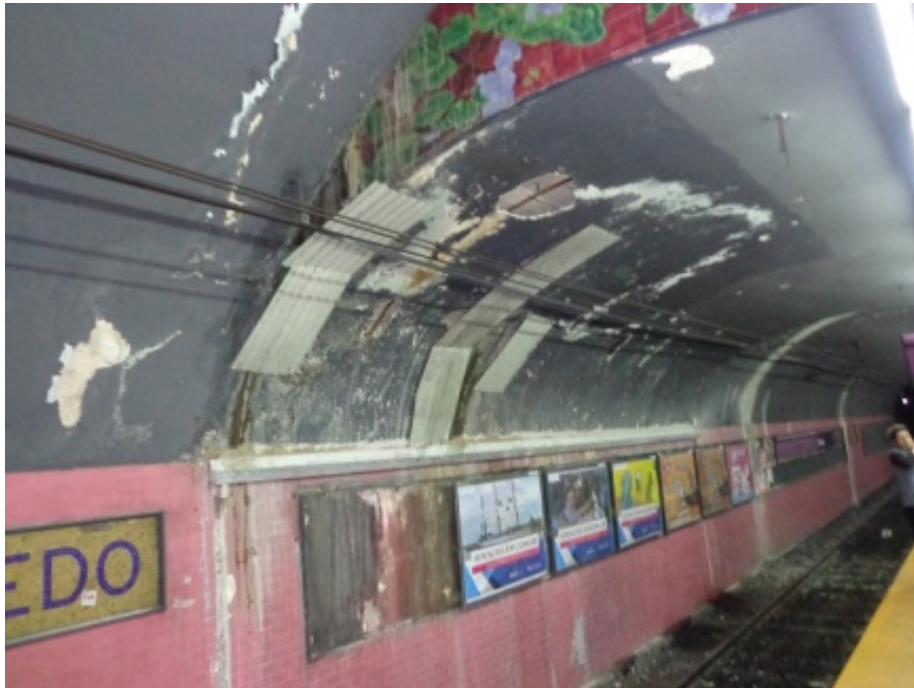
Filtraciones de agua y humedad en paredes y cielorrasos. Estación Boedo - Línea E
