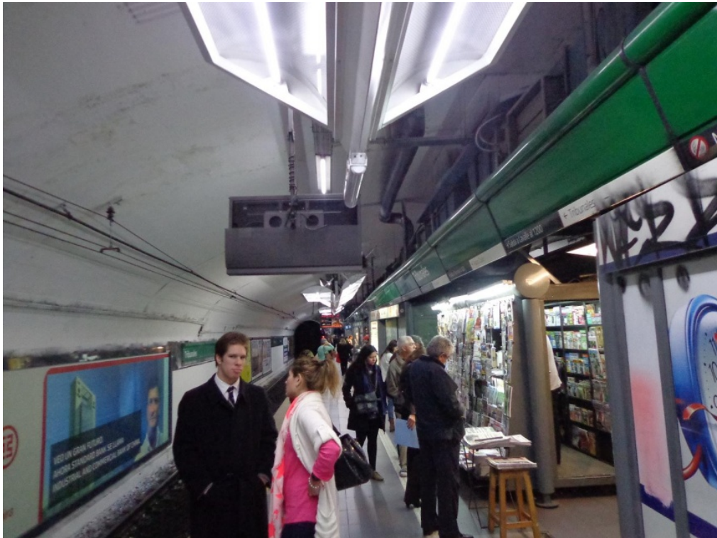
Estrechamiento de los andenes por locales y consiguiente riesgo de caídas. Tribunales – Línea D
