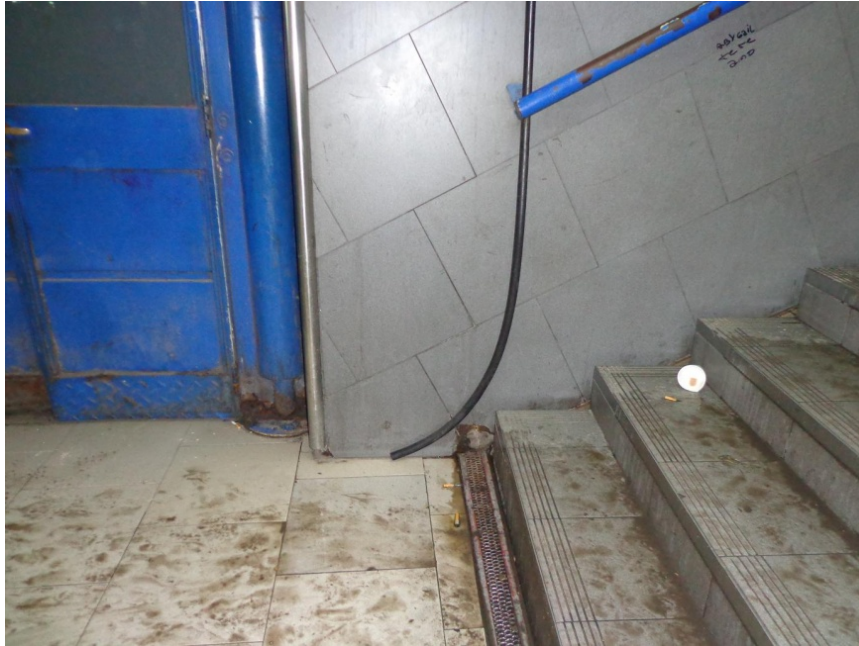
Agua y arena en escalera con riesgos de caída y tropiezos. Constitución – Línea C
