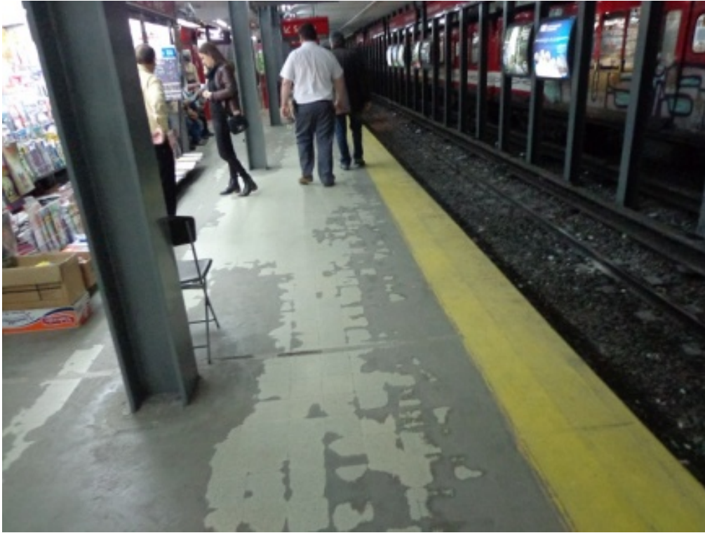
Pisos en mal estado o desgastados. F. Lacroze – Línea B
