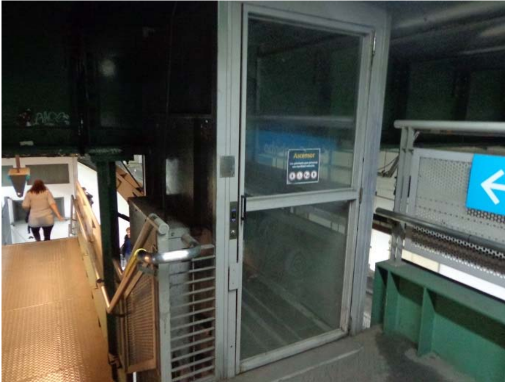
Ascensor fuera de servicio andén sur Plaza Miserere - Línea A
