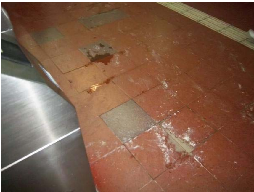
Goteras y posterior acumulación de agua. Catedral – Línea D
