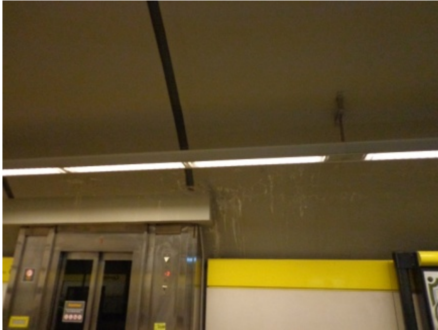
Iluminación general de andenes sin protección en los tubos para evitar su desprendimiento. Corrientes – Línea H
