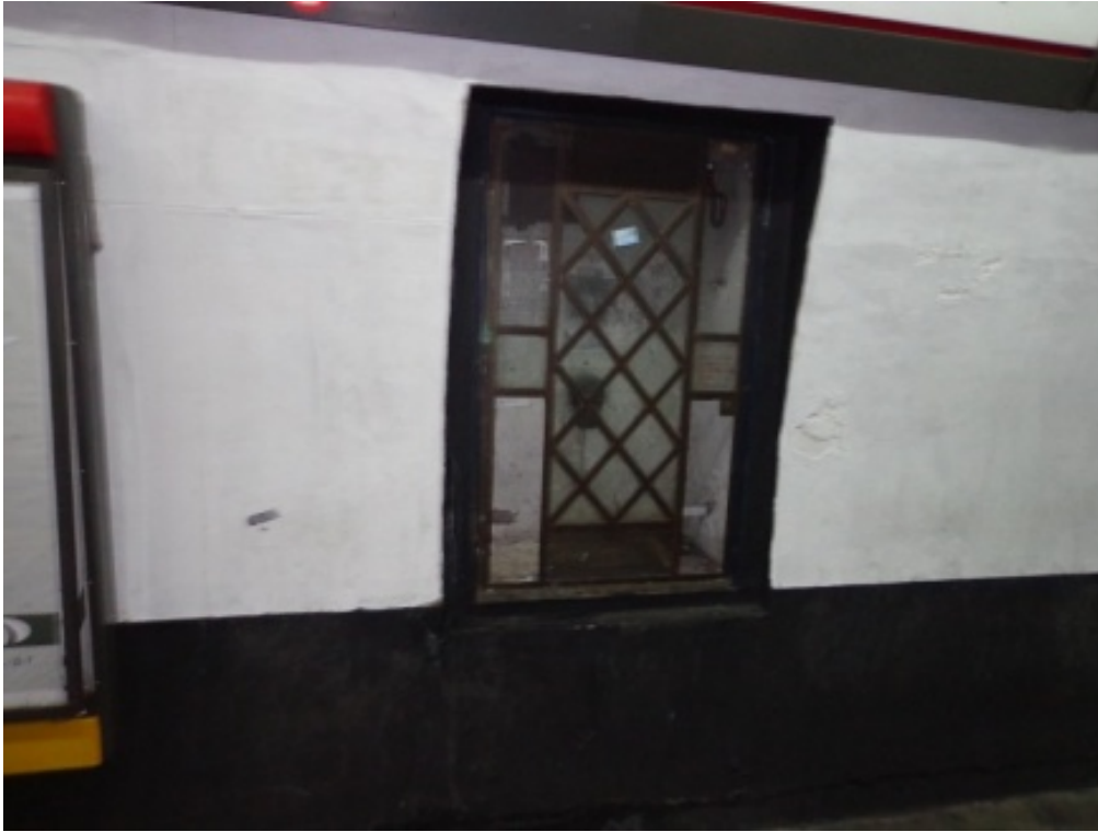
Antigua instalación fija de incendio con llave de teatro de 63.5mm Pueyrredón – Línea B
