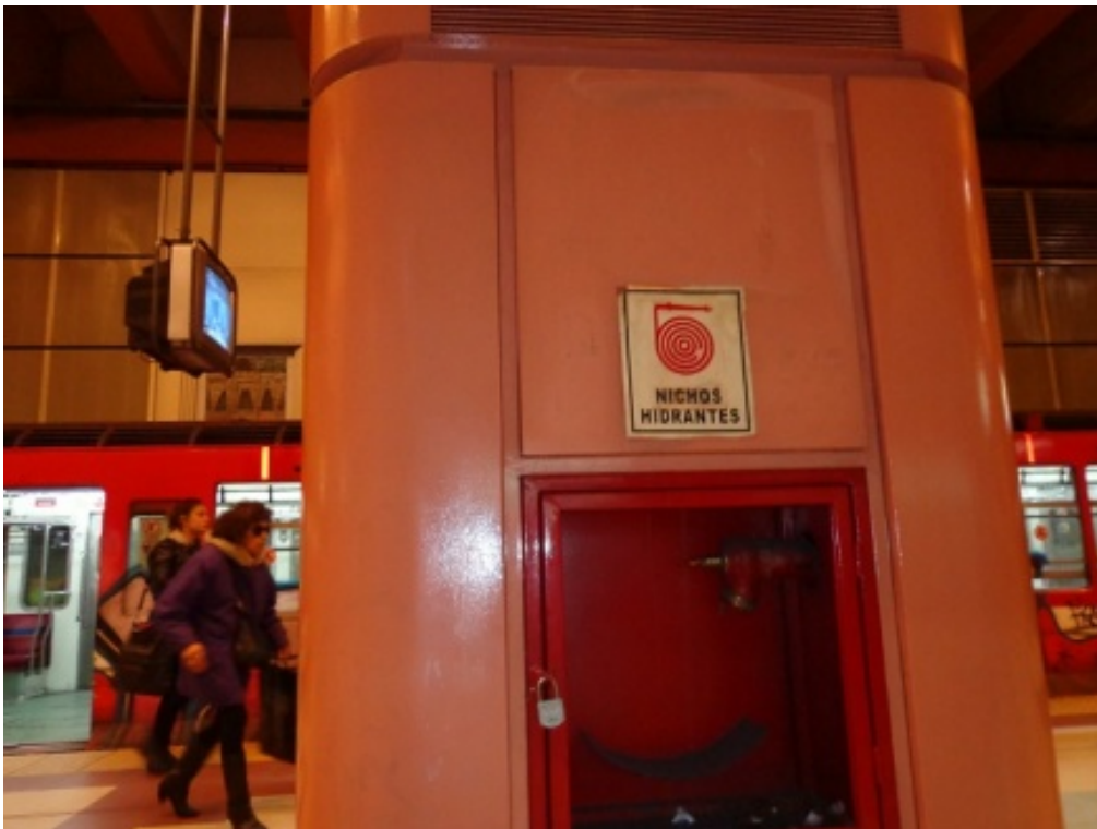
Nicho de incendio vacío Los Incas – Línea B
