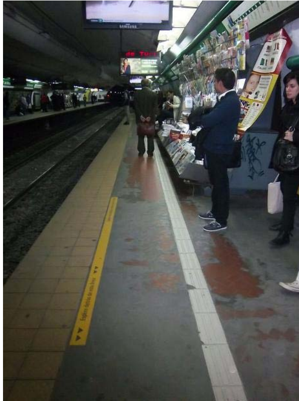
Pisos en mal estado e ídem dos anteriores. F. de Medicina – Línea D
