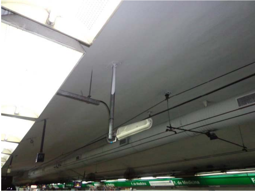
Antenas de celulares en andenes. F. de Medicina – Línea D
