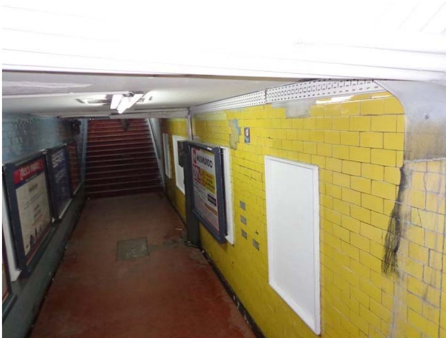
Filtraciones de agua y humedad en paredes y cielorrasos. Lima – Línea A
