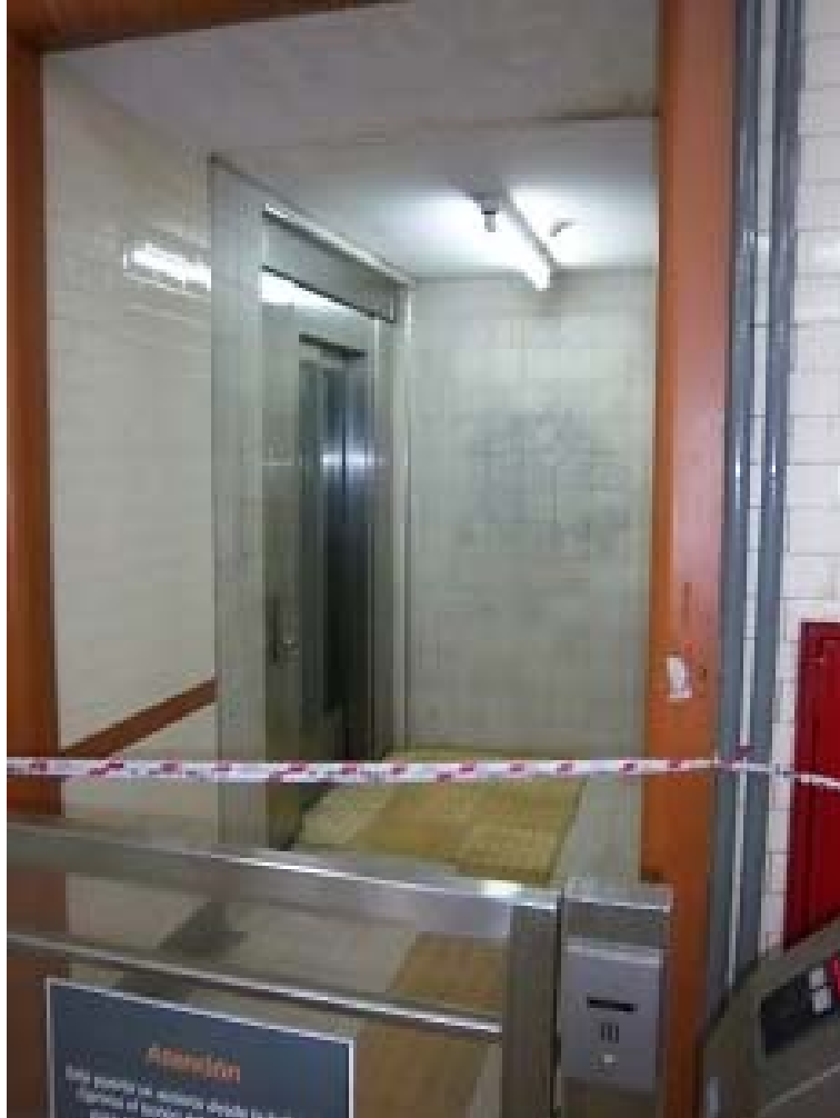
Ascensor fuera de servicio estación Perú - Línea A
