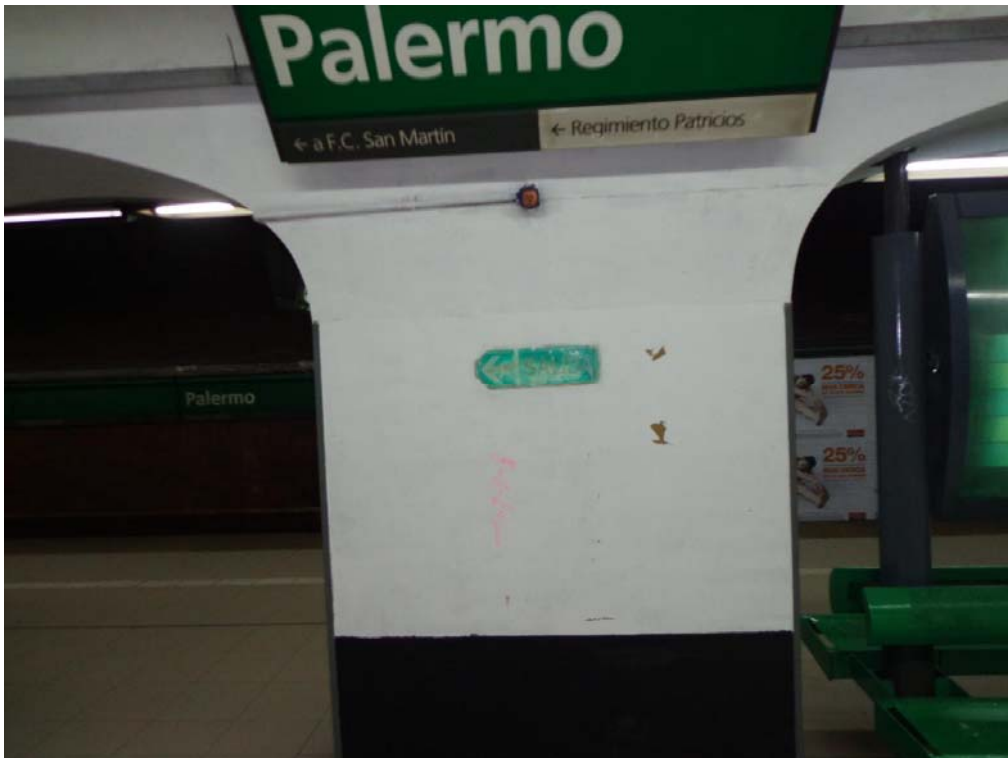
Señalización en mal estado de conservación. Línea D
