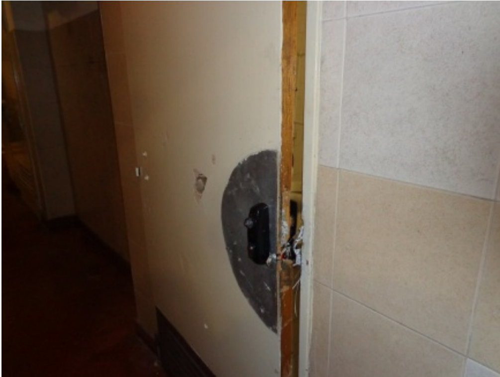
Puerta de baño violentada, la misma se encuentra detrás de la boletería en estación Los Incas – Línea B
