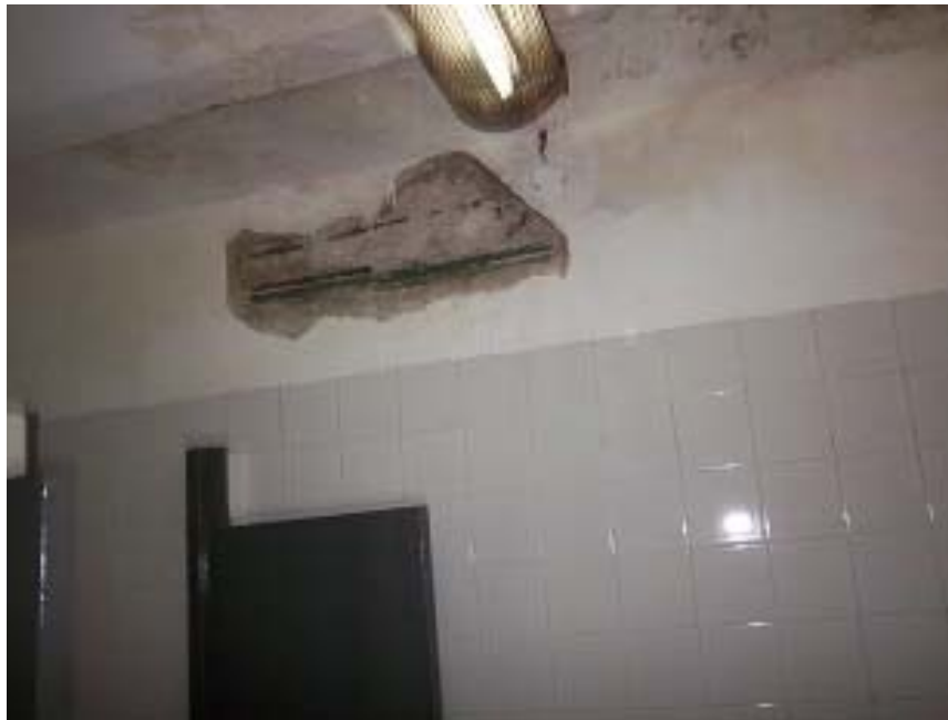
Filtraciones de agua y humedad en paredes y cielorrasos. P. de Mayo – Línea A
