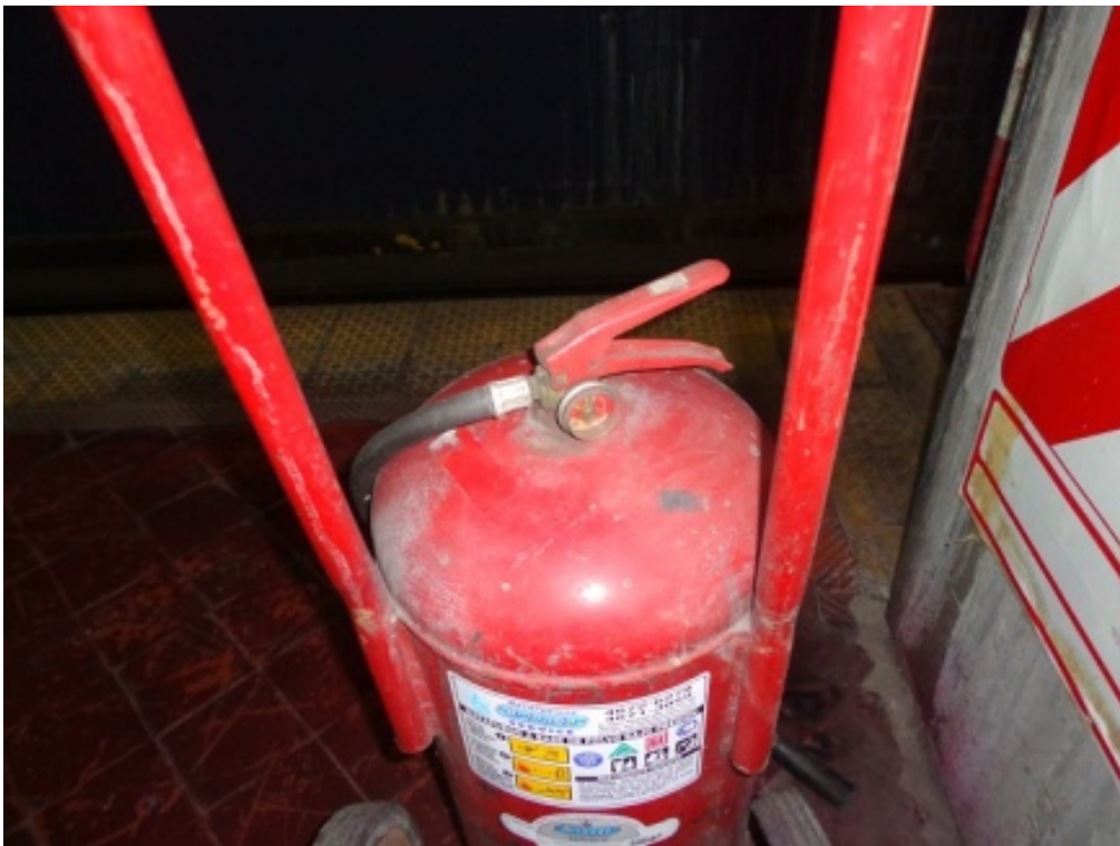
Extintor descargado. Independencia – Línea E
